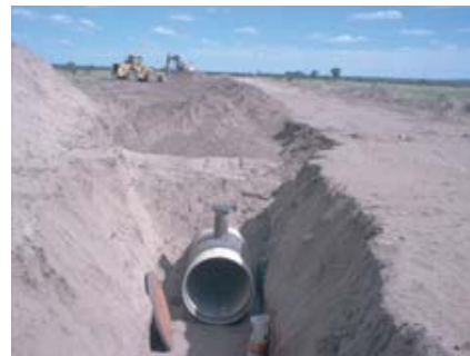
Ramal Te para venteo. Todos los accesorios, ramales para venteo y limpieza, curvas, etc fueron fabricados en PRFV. Los mismos totalizaron más de 200 unidades.
