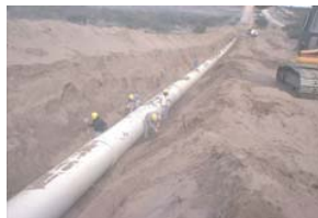
Arriñonado de tuberías
