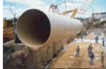
Se está instalando una tubería de 12m de longitud sobre un lecho de arena/geotextil en Central Puerto.
