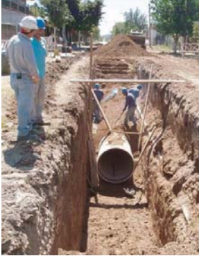
Matanza Los Cedros. Relleno y compactación en la zona de tubo DN 1200
