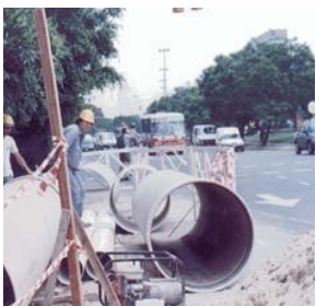
Pluvio Cloacal Radio Antiguo DN 1000 mm.
